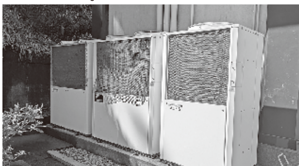
故障したエアコンの室外機
